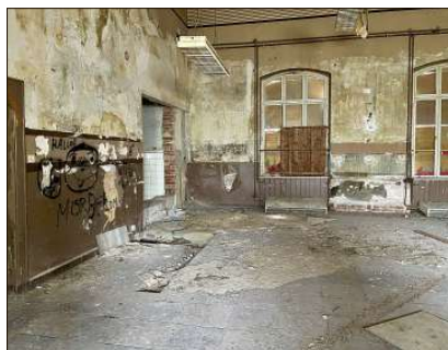
Einsam, still und renovierungsbedürftig ist es im Inneren des Schönebecker Bahnhofes. Die Sanierung durch die SWB hat immer noch nicht begonnen.
