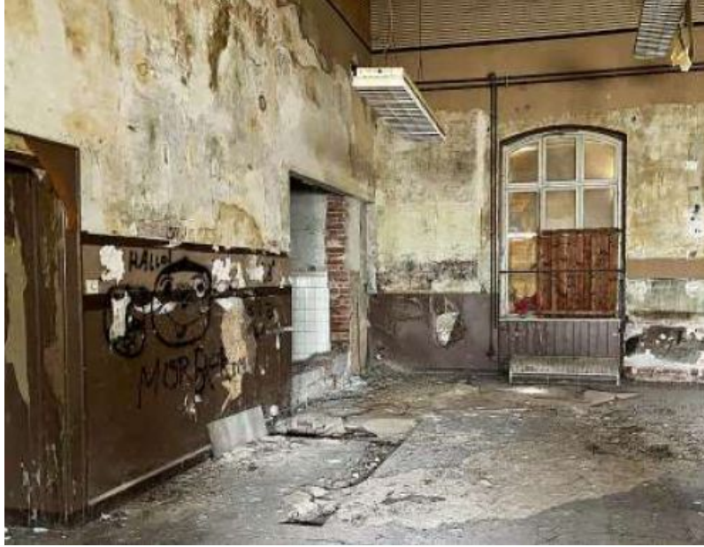
Die Innenräume des Schönebecker Bahnhofs sind sanierungsbedürftig.
